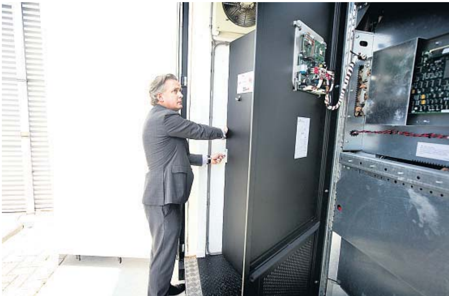
Huub van Raamsdonk van Elinex noodstroomapparatuur. 'Ahoy kan het zich niet permitteren dat het licht uitgaat.' Foto: Mirjam van der Hoek
